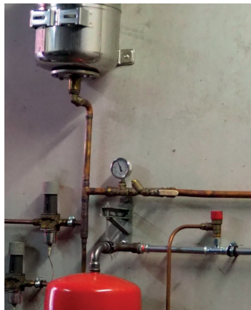
Sammutusvesijärjestelmä. Huomaathan pitää vesihanana aina auki
